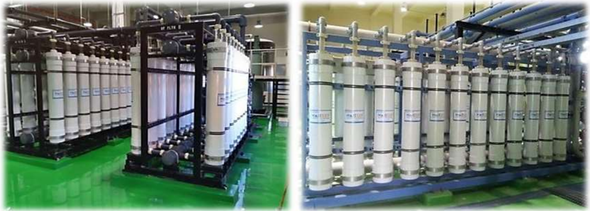
UF Membrane 설치 모습(삼척 화력발전소 / 울촌 복합화력발전소#2)
